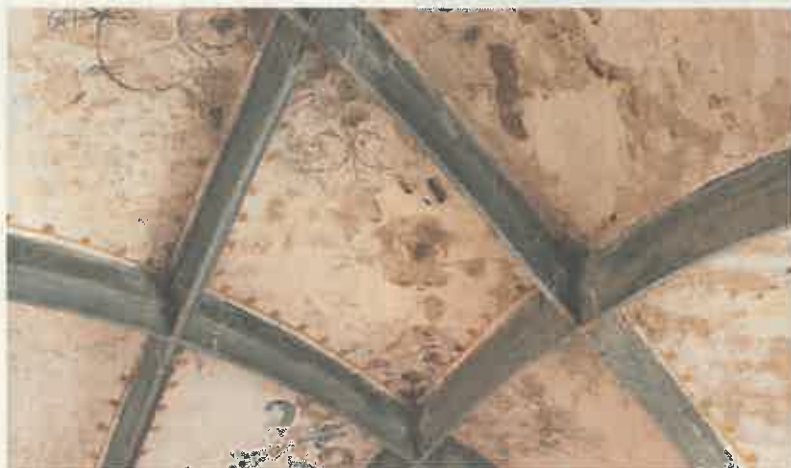
Die Farbschicht des sogenannten „Kräuterhimmels“ blättert ab. Ursache ist unter anderem ein Wasserschaden aus dem Jahr 1976. FOTO: SCHELLHORN
